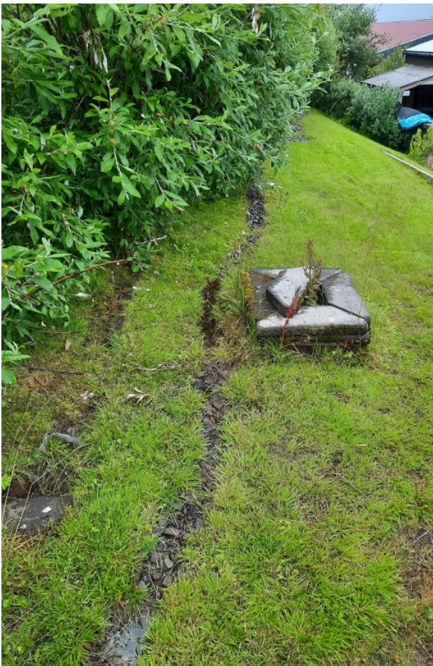
Mynd 4: Hér sést ofan á yfirborðið á drenskurðinum sem liggur efst í lóðinni. Vatn liggur efst í skurðinum.
